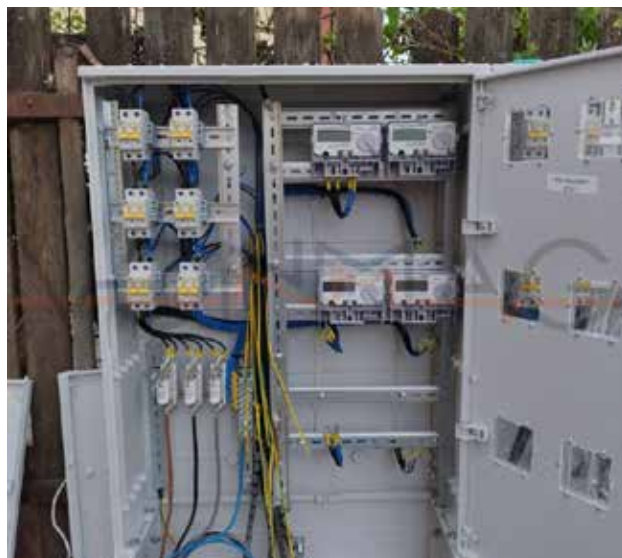
Firida cu contoare inteligente, concentrator de date și modem pentru transmiterea datelor
